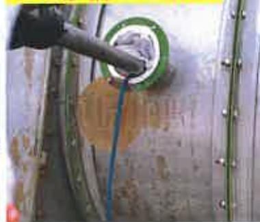
1#CVD 排气筒-30315 进口OX
